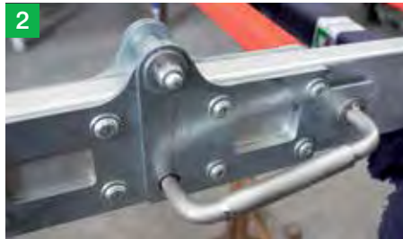
2 Beschädigter zu tauscher Rastriegel.
