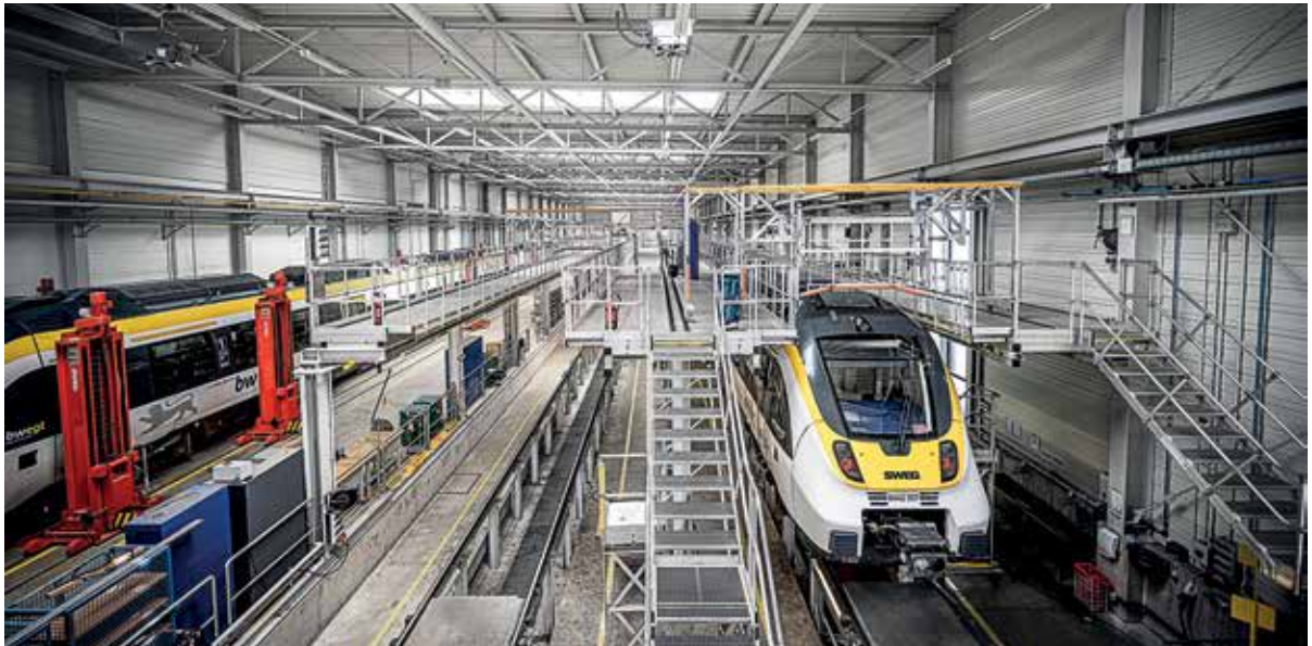
Dank der neuen Dacharbeitsanlage können die Mitarbeitenden der SWEG auf zwei Gleisen gleichzeitig arbeiten.
