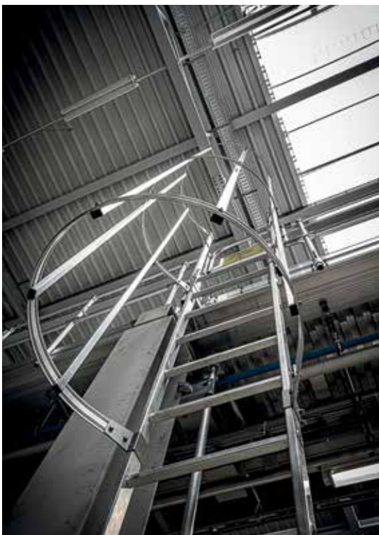
Über Notabstiegsleitern am dritten Dacharbeitsstand kann die Anlage im Ernstfall verlassen werden.
